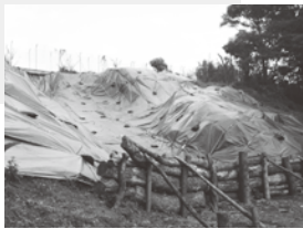
▲キャンプ座間 崩落地
